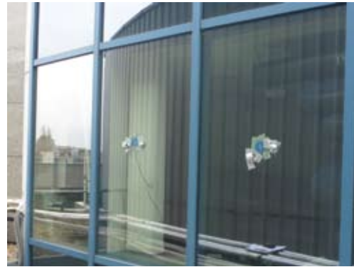
Pohľad na snímače tepelného toku z exteriéru.
